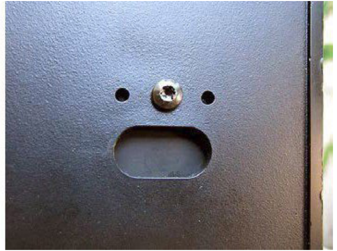
Der stillgelegte ursprüngliche Netzanschluß
